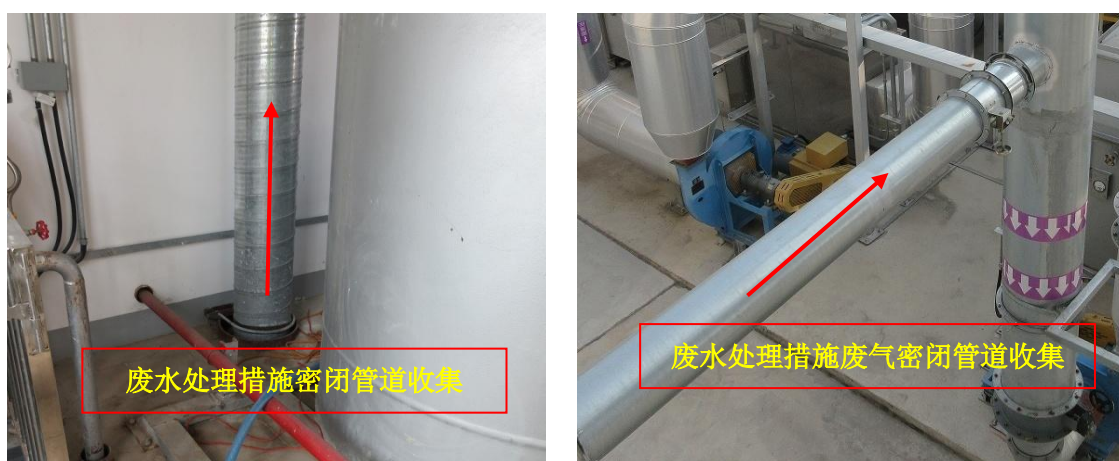
图 4.1-4 污水处理站废气收集方式示意图
