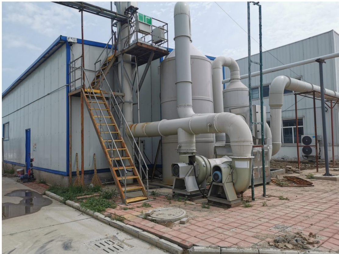
图 4.2-3 碱液喷淋+水喷淋+活性炭吸附装置
