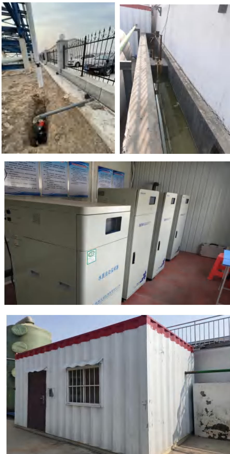
图 4.3-5 废水排放口、在线监测设备
