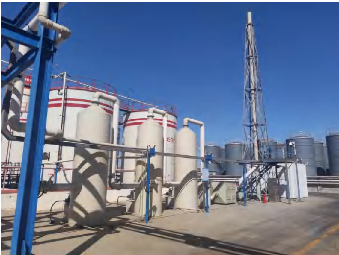
图 4.2-7 TA009、TA010、TA011 废气处理措施+DA003 排气筒建设情况
