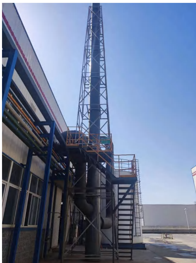
图 4.2-8 TA016、TA017、TA018 废气处理措施+DA004 排气筒建设情况
