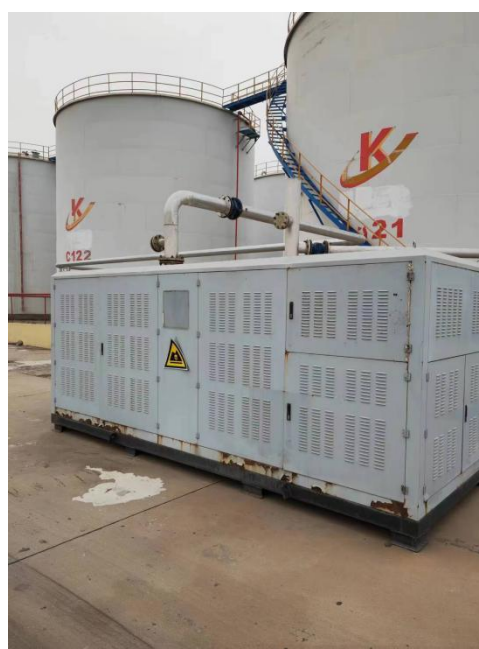
冷凝+活性炭装置
