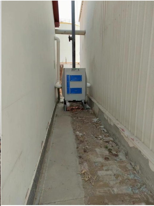
危废间废气处理设施及排气筒
