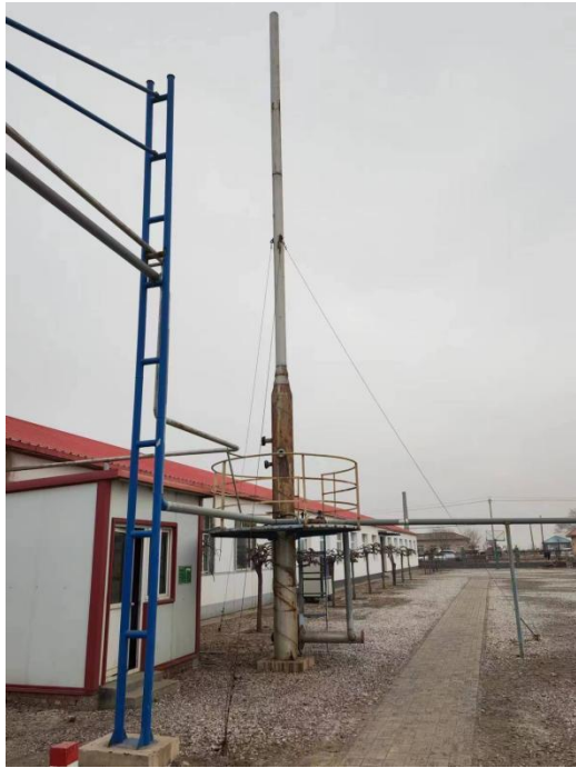
装、卸车废气排气筒
