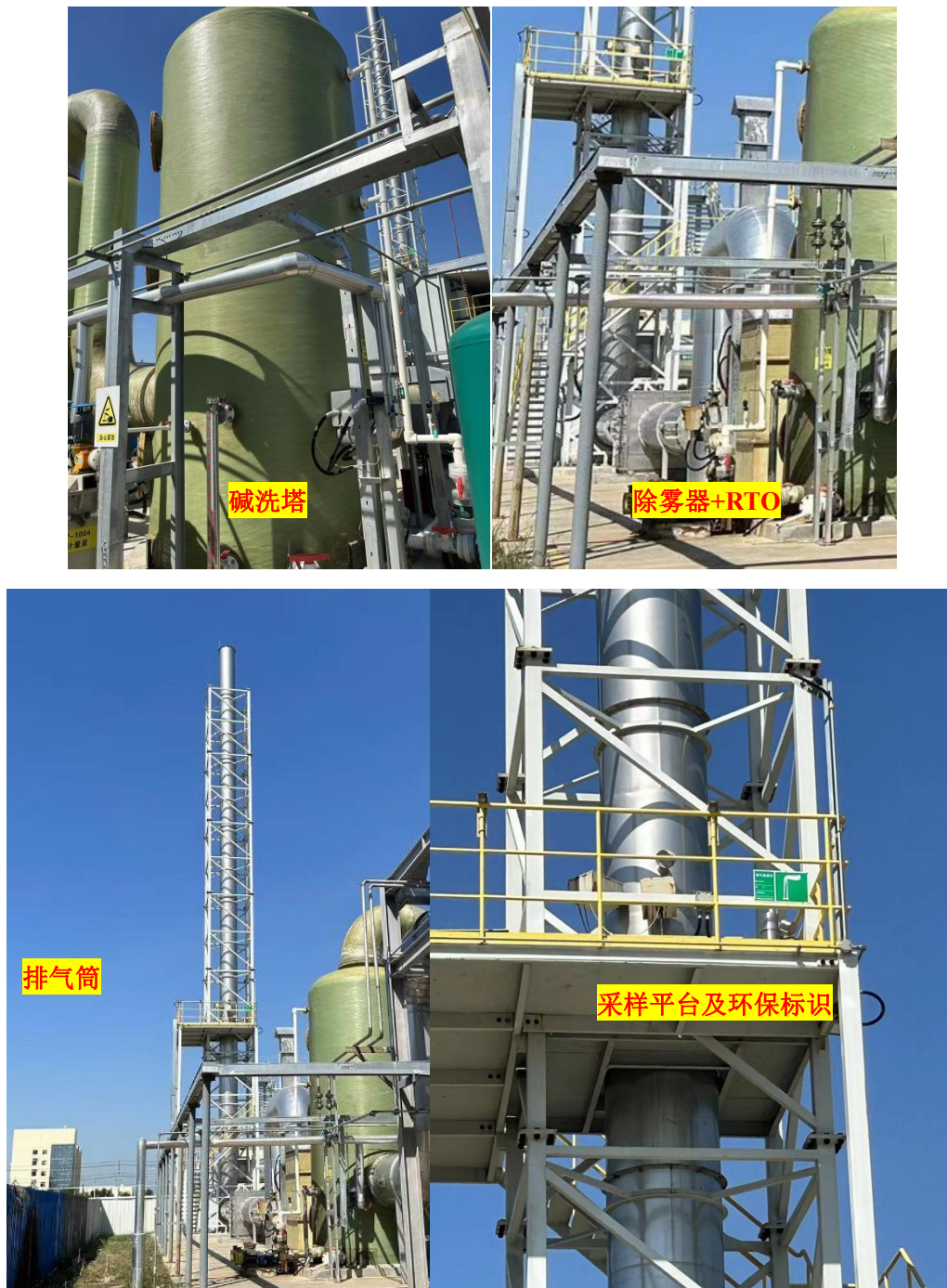
图 4.2-1 废气处理措施建设情况
