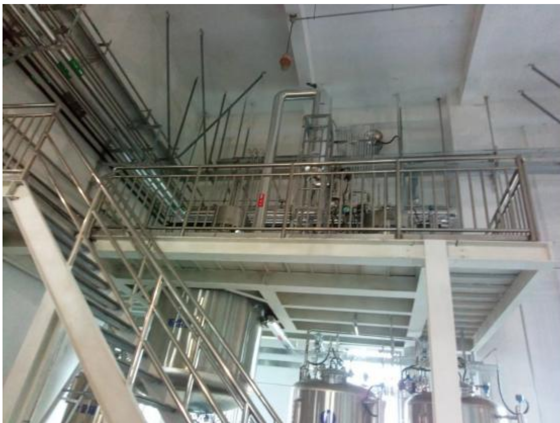
图 4.2-2 废气收集装置——密闭管道
