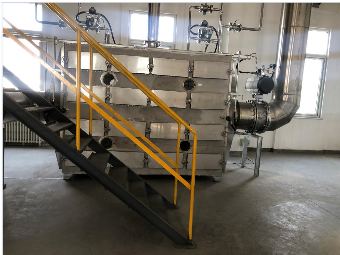
图 4.2-3 应急旁通活性炭吸附装置
