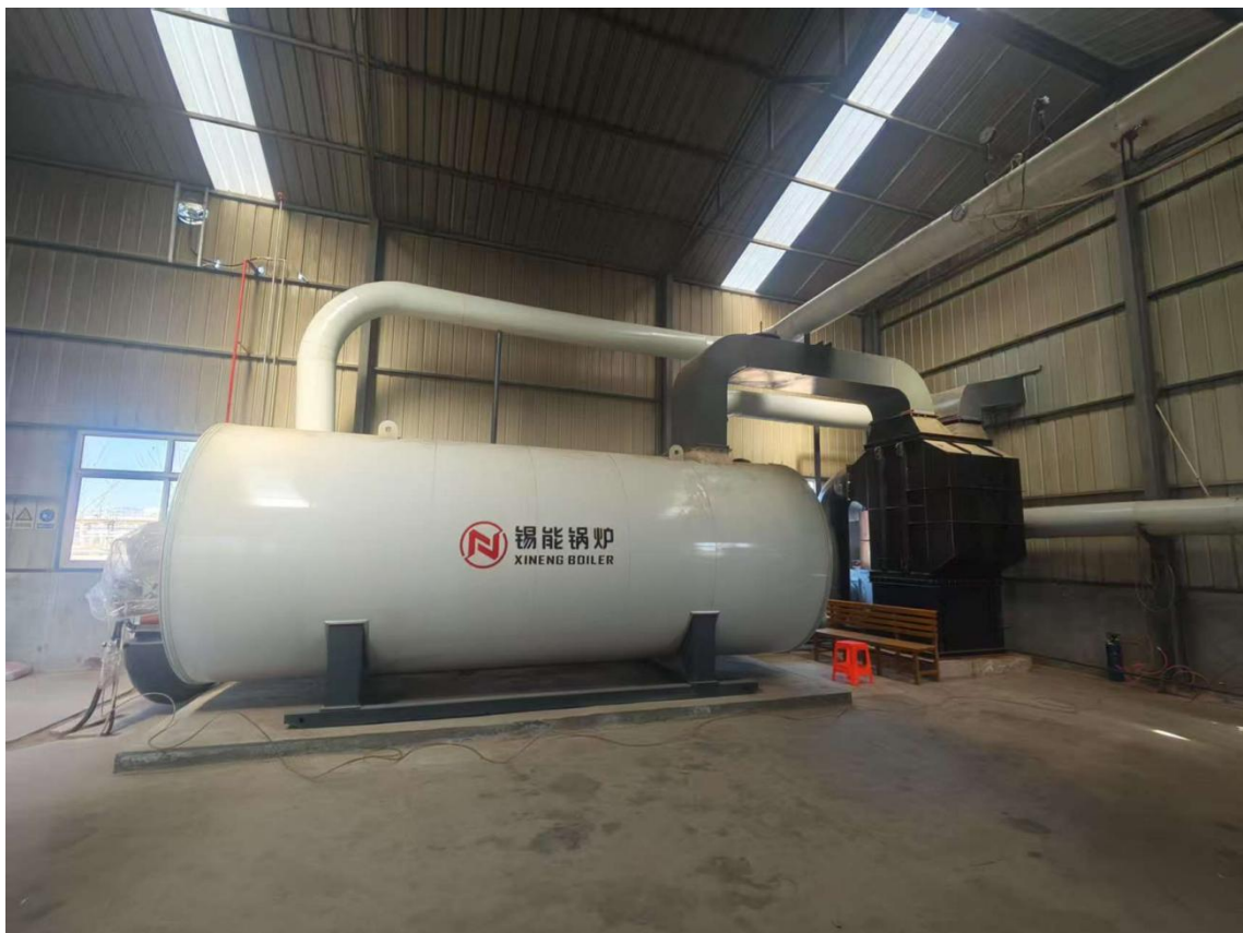
图 4.2-1 燃气锅炉级低氮燃烧系统处理措施建设情况
